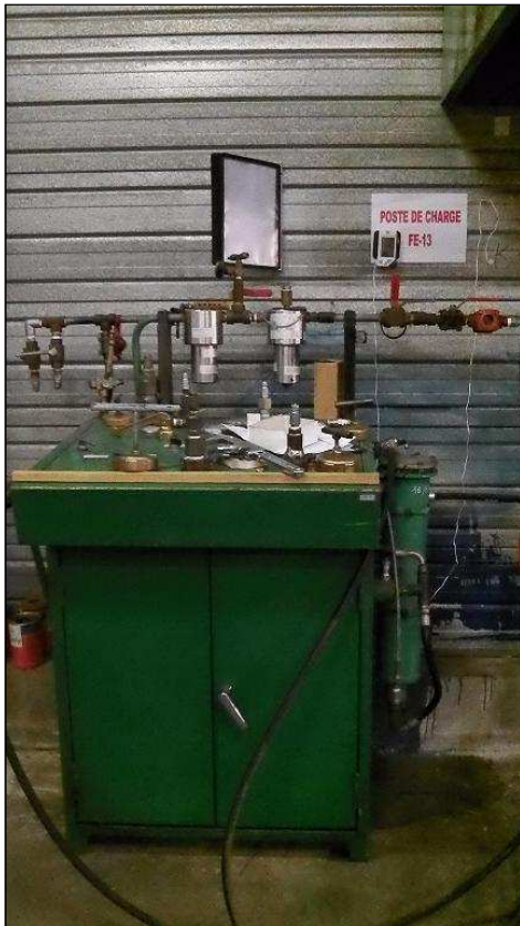
Poste de charge HFC23
