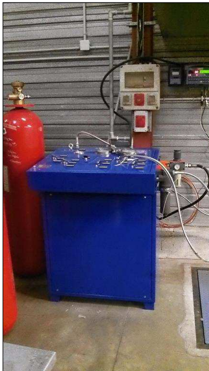
Poste de charge HFC227ea
